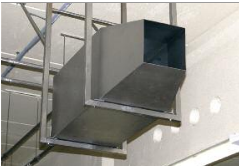
Einer der Transportlüfter für die Optimierung der Luftströmungsverhältnisse
