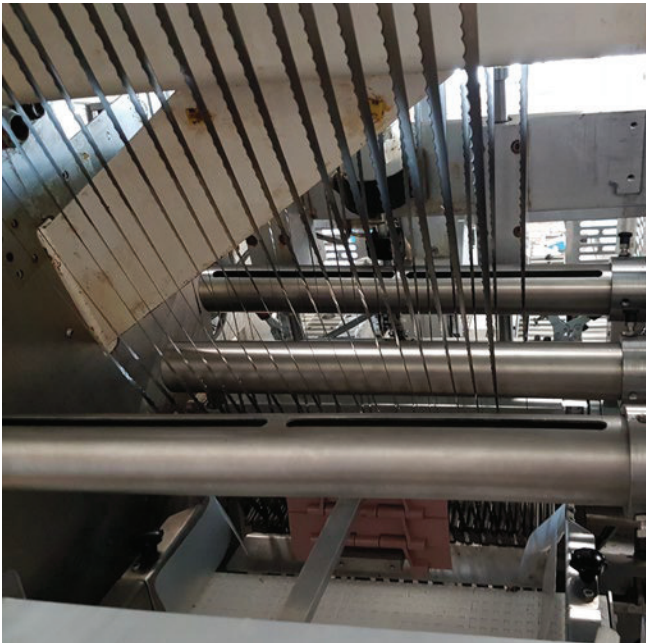
Absaugrohre in einer Schneidemaschine
