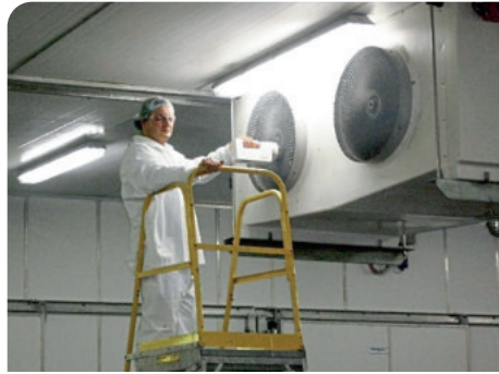
Abb. 3: Im Rahmen einer hygiene-klimatischen Betriebsumfeldanalyse werden auch raumlufttechnische Anlagen und Zuluftsysteme untersucht und bewertet.
