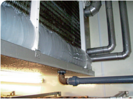
Abb. 2: Vereisungen am Kühlregister treten als Auswirkung von Feuchteverschleppungen häufig auf. Die Erfassung der Luft- und Oberflächenbelastung hilft, das zu vermeiden.
