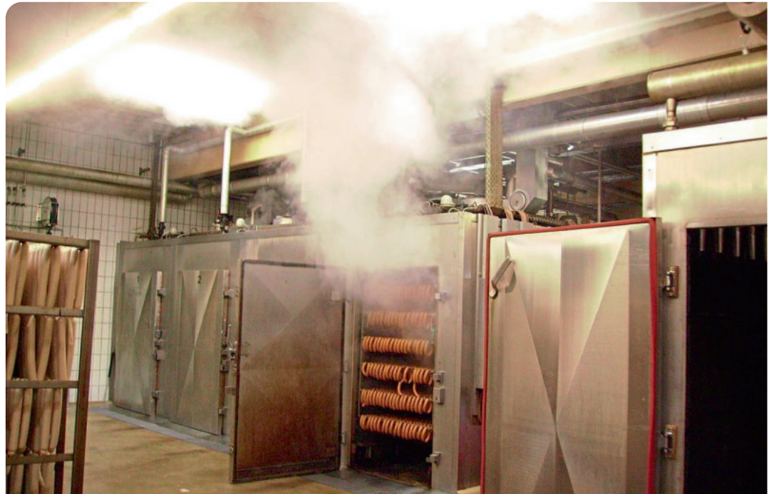
Abb. 1: Unkontrollierte Schwaden haben einen negativen Einfluss auf die Betriebshygiene und die Gebäudesubstanz.
