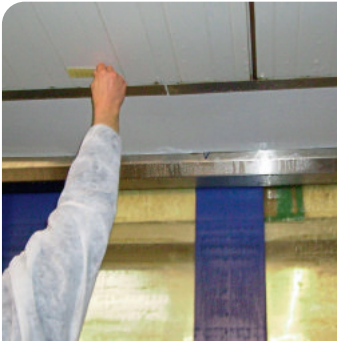
Abb. 1: Wenn warme feuchte Luft auf kalte Oberflächen trifft, bilden sich Kondensstropfen.
