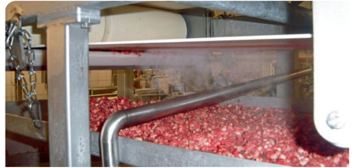
Abb. 3: Insbesondere Förderbänder haben intensiven Kontakt zum Rohstoff – deshalb sollten sie zusätzlich abgesichert werden. Frischfleischprodukte haben zudem die höchste Hygienestufe.
