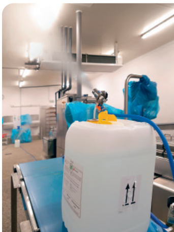
Beim Einsatz der Zweistoffdüse erfolgt die Vernebelung mit Druckluft.
