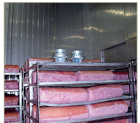
Erfassung des Hygienesrisikos in der Raumluft im Kühlraum.
